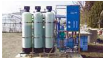
農業用水設置使用例
